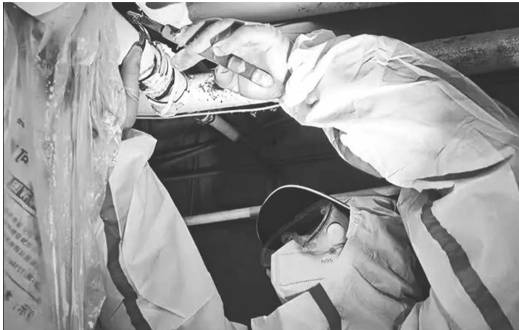
11月28日,长春市供热集团检修人员修理管道并活结处漏水。受访对象供图
