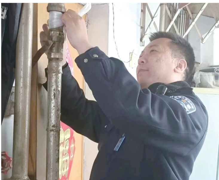
民警就地取材用塑料袋将供热管缠住,暂时控制住渗水 警方供图
