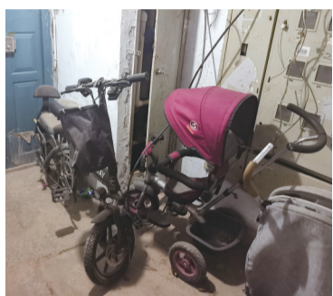
楼道内停放电动车存在消防安全隐患 城市晚报全媒体记者 吕闯 摄
