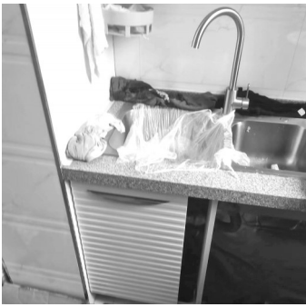
堵塞的厨房下水道
