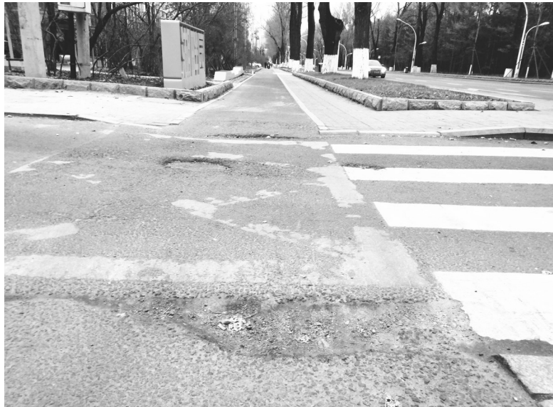
破损路面亟待修复 本组图片 城市晚报全媒体记者 刘佳雪 摄
