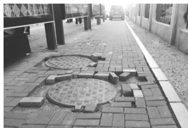
井盖塌陷且方砖缺失
