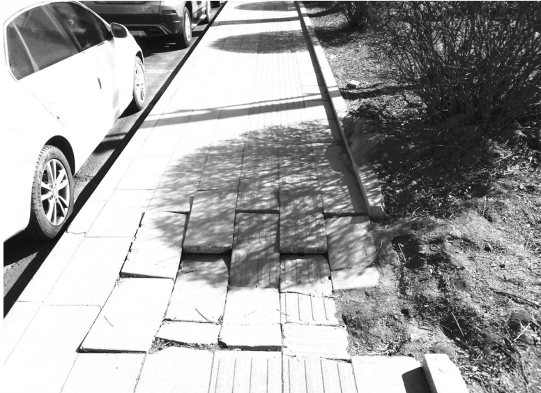
路面塌陷影响市民通行 本组图片 城市晚报全媒体记者 刘佳雪 摄
