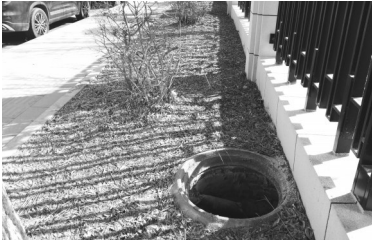
井盖缺失有隐患
