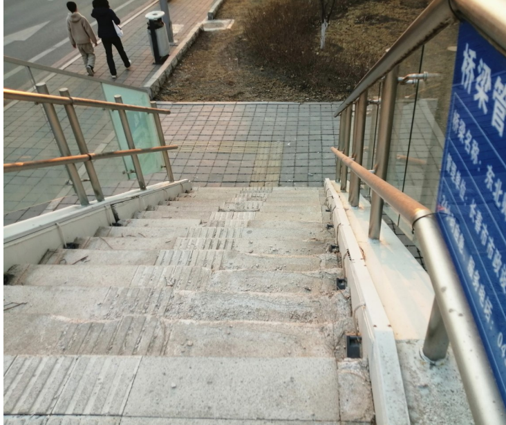
破损的台阶亟待修复
